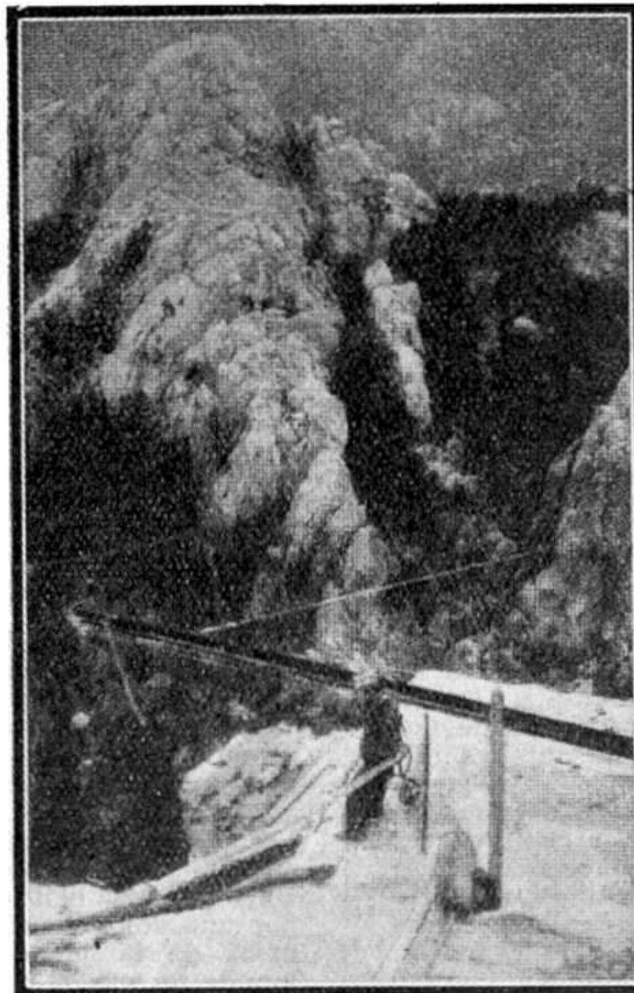
Suspendus à cette poutrelle d'acier, des ouvriers travaillent au-dessus de l'abîme, pour tailler le granit.
