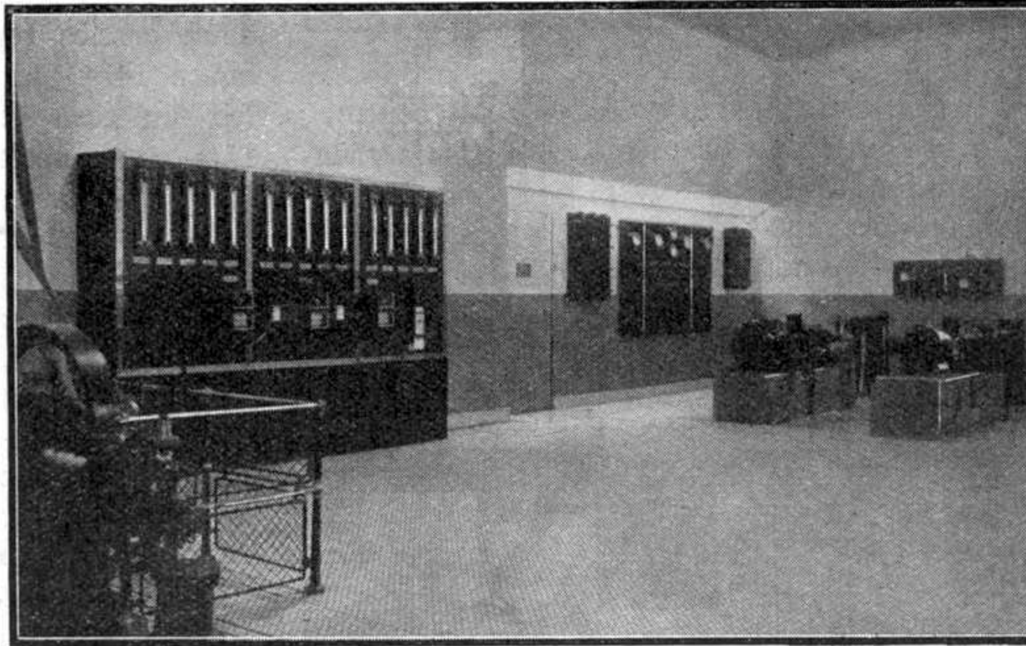
Salle des machines à l'Usine de Vannes. A droite, les deux groupes surpresseurs. Ce document nous a été communiqué par l'auteur de l'article, notre lecteur et ami Loïc, membre de la Gilde Meccano
